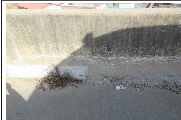
방호벽 망상균열 및 백태 S2
