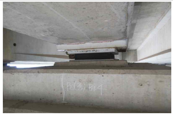
받침 콘크리트 균열(0.3mm 미만) P2 A2-SH4
