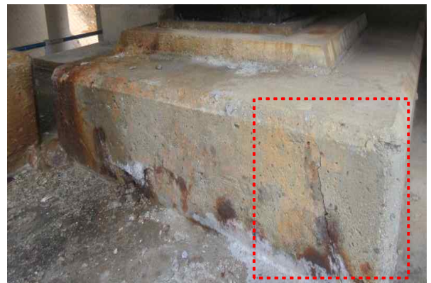
받침콘크리트 박리 P2 A1-SH6
