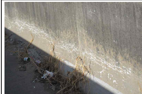
방호벽 망상균열 및 백태 S2
