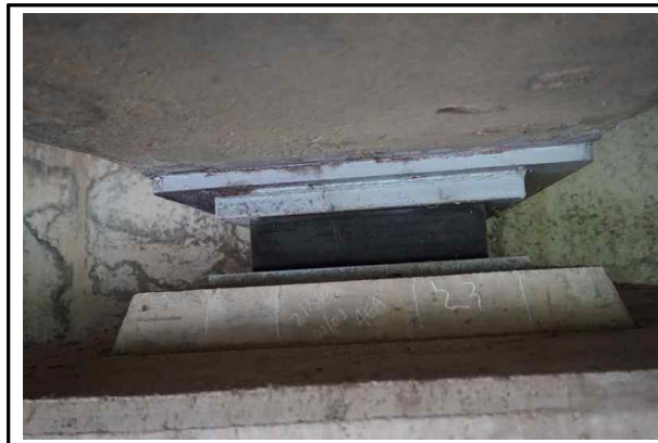
받침물탈 균열(0.3mm 미만) A2 SH2
