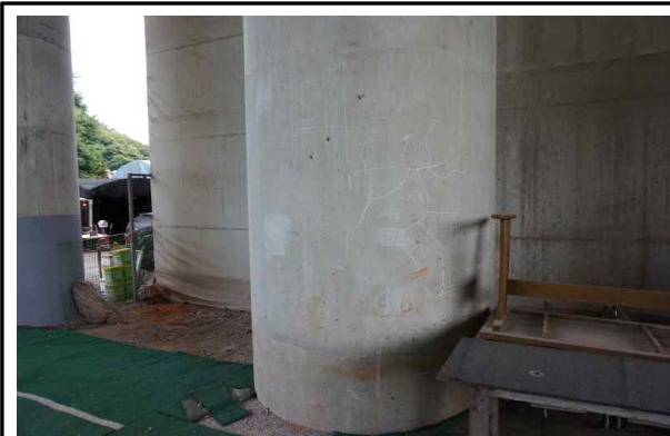
교각 망상균열 P1
