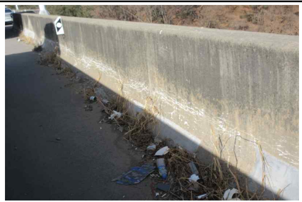
방호벽 망상균열 및 백태 S2
